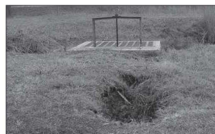
Töltéskorona kiüregelődés a Kiskengyeli bevízcsatorna műtárgyánál
