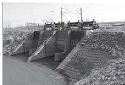
Az Nkfc. kulcsfontosságú, 14. jelű vízszintszabályozó műtárgya
