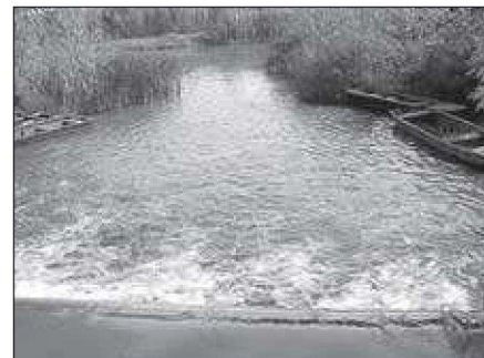
Csillapító medence a Mirhó szivattyútelepén
